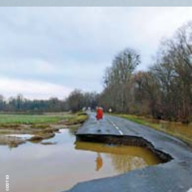
Route endommagée par la crue de décembre 2003, Maringues (63).
